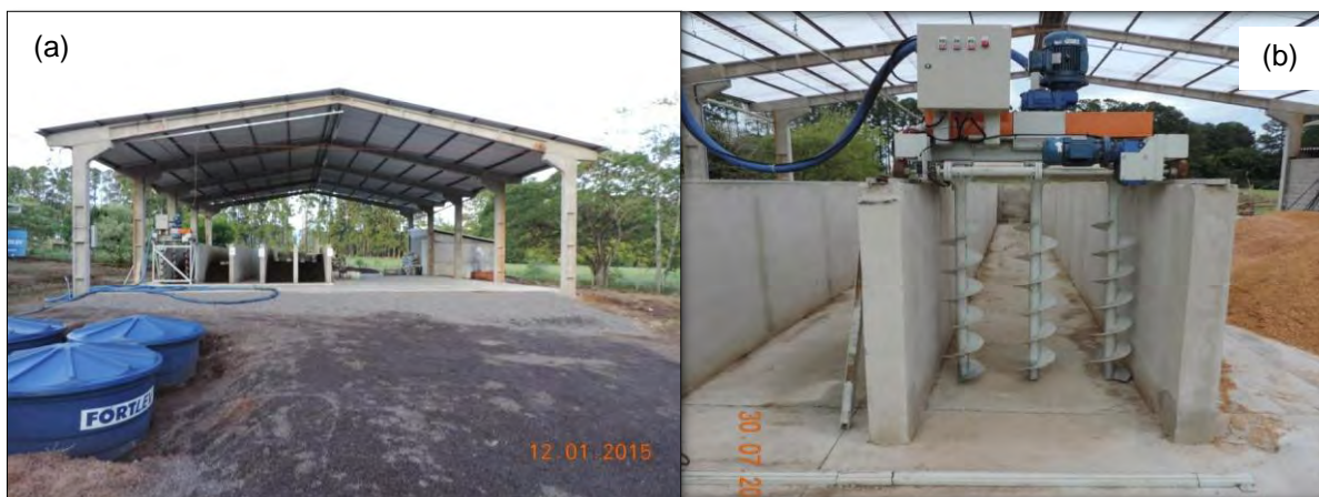
Figura 2. Vista geral da plataforma de compostagem (a) e revolvedor vertical de compostagem (b).
